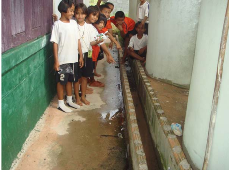
จุดที่ 11 ข้างโรงอาหารมีน้ำขังเกิดตะไคร่น้ำ
