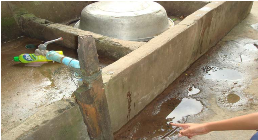
จุดที่ 2 ที่ล้างจานบริเวณโรงอาหารน้ำระบายระบายไม่ได้ทำให้น้ำขัง
