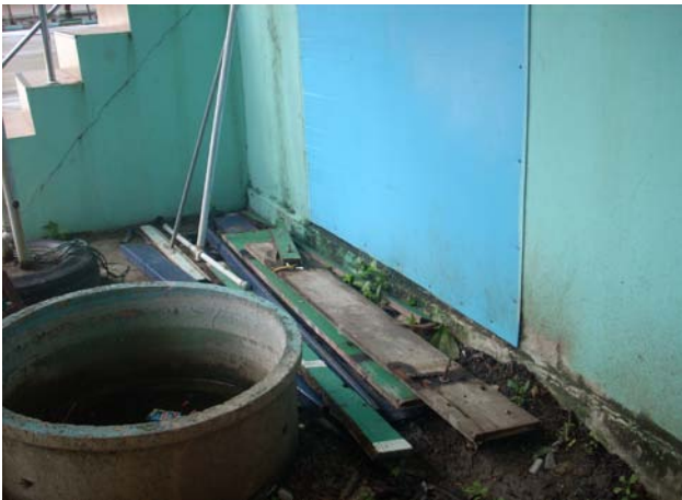
จุดที่ 1. ข้างเวทีมีเศษไม้และตะปุกองอยู่ มีความเสี่ยง 40 % นักเรียนอาจโดนตะปุกแทงได้
